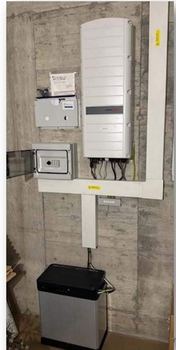
Inverter e batteria
