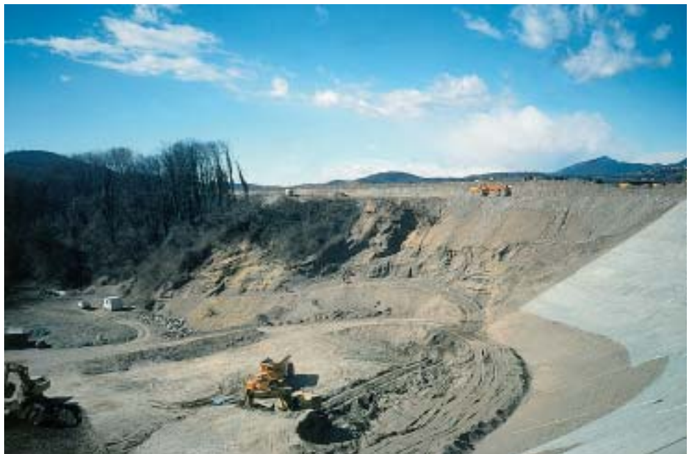
Veduta parziale della ex-cava nella parte centrale della Valle della Motta (settore W) all'inizio dei lavori di sbancamento e di riporto (Foto M. Felber, marzo 1990).
